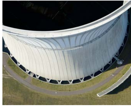
Identifizierung von innen- und außenliegenden Schadstellen an einem Kühlturm
